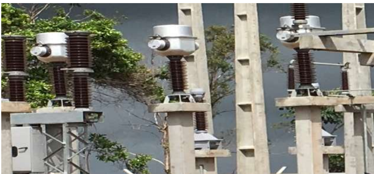
Figura 7– Transformadores de corrente Fonte: Subestação (Fonte: Subestação).
