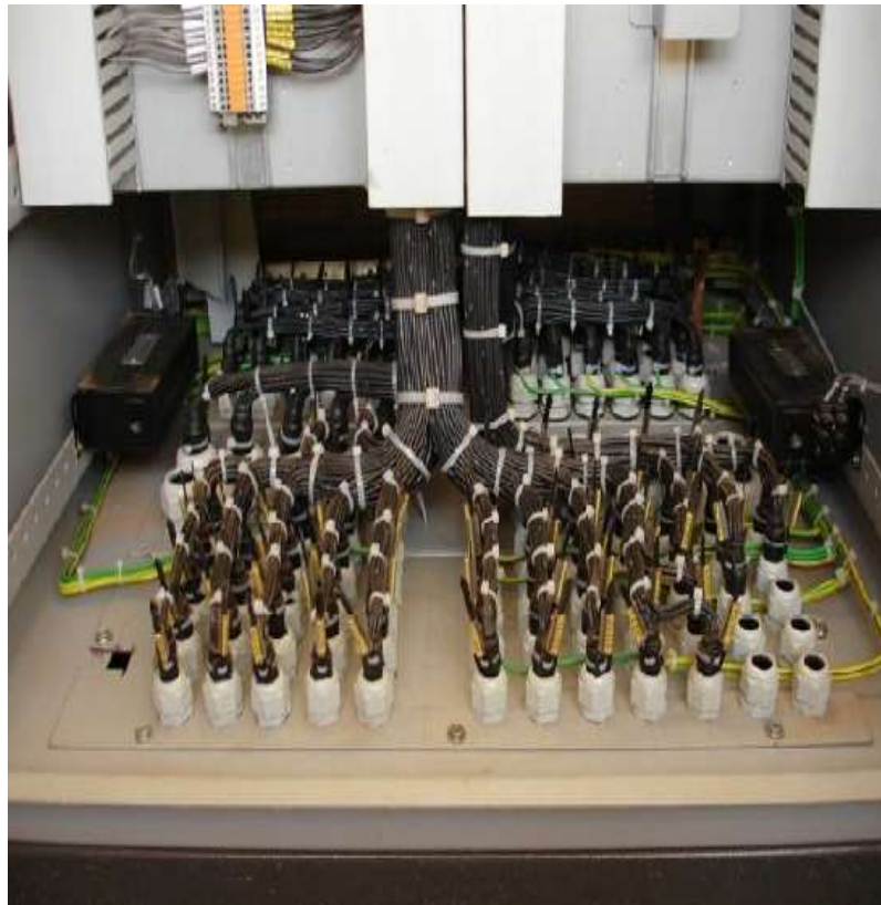
Figura 14 – Cabos chegando do campo ( Fonte: Retirada Painel de relé).
