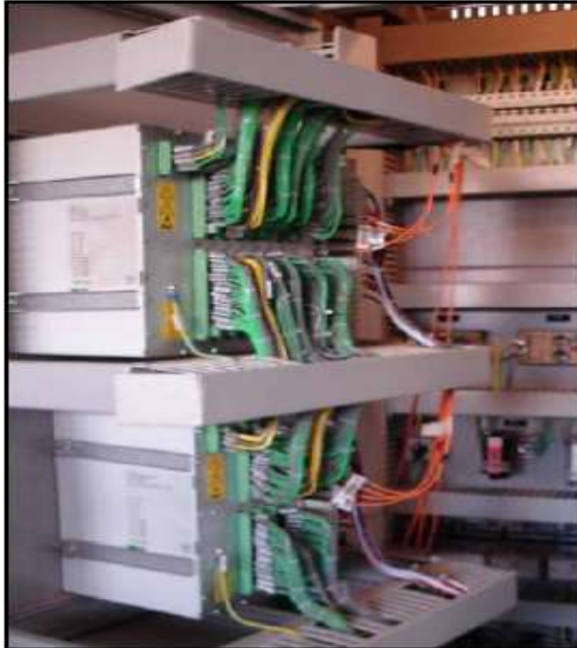
Figura 13 – Cabos interligados os I/O dos IEDs (Fonte: Retirada do Painel de relé)
