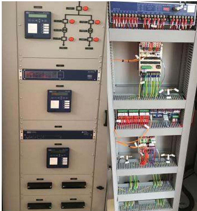
Figura 19 – Painel de relé (Fonte: Casa Painéis da subestação PN-001).
