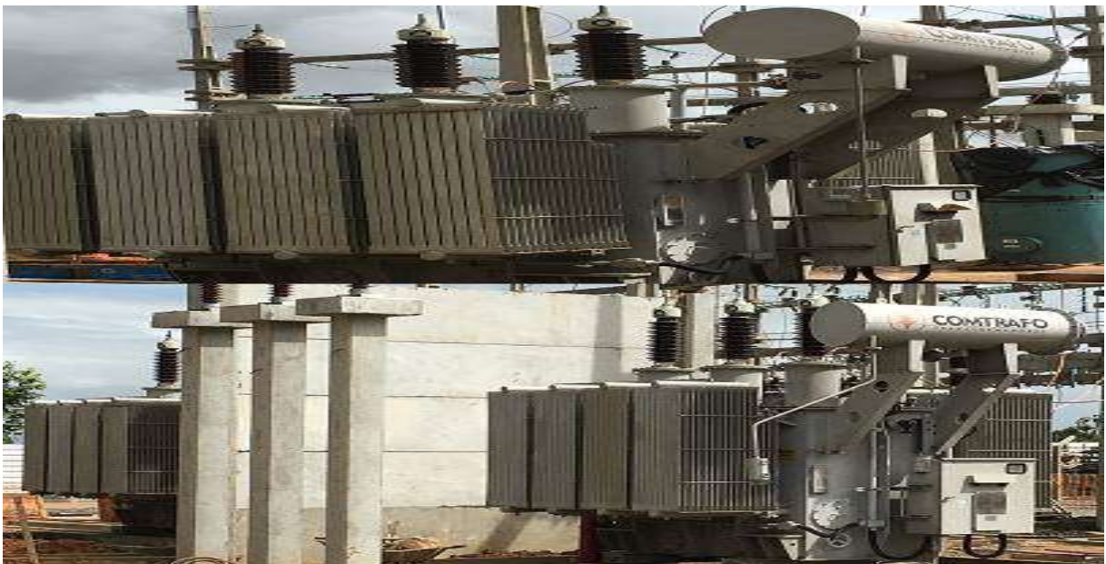
Figura 3 - Transformador de força (Fonte: Retirada da área da subestação).
