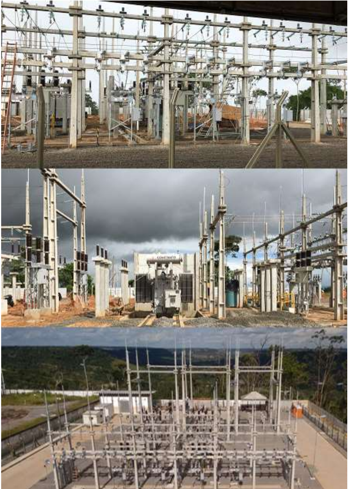
Figura 1 - Subestação elétrica de (69/13.8)kV (Fonte: Retirada no campo de construção da subestação em fevereiro de 2017).
