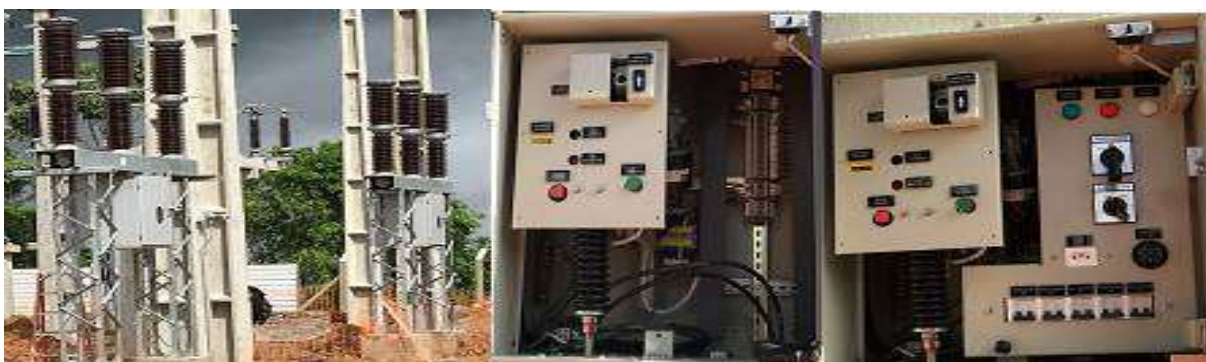
Figura 9 – Chaves seccionadoras trifásicas. Fonte: Retirada da subestação.
