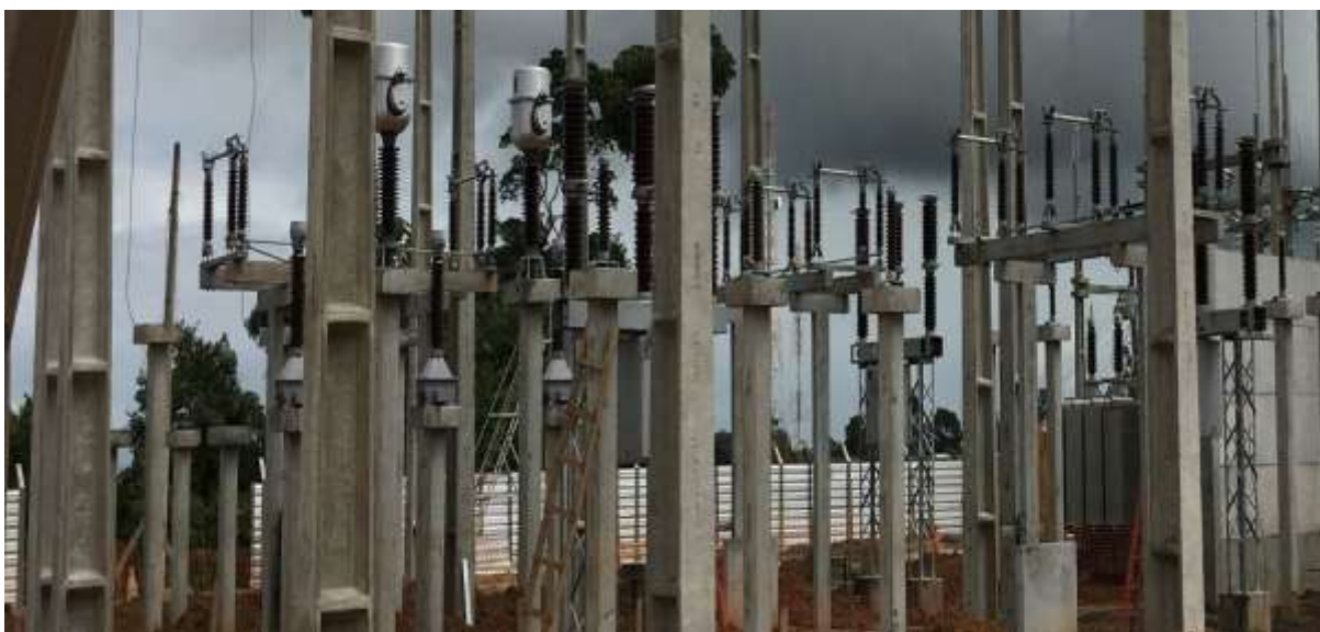
Figura 8– Chaves seccionadoras trifásicas (Fonte: Retirada da subestação).
