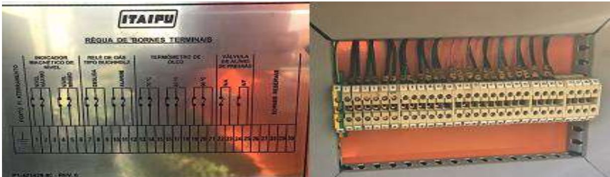
Figura 2- Régua de borne do transformador ( Fonte Retirada do transformador)
