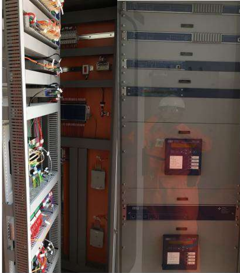
Figura 18 - Painel de relés (Fonte: Casa de painel da subestação PN-002).
