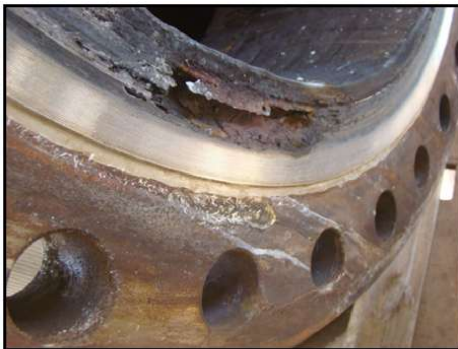
Figura 3 - Foto do bocal danificado
