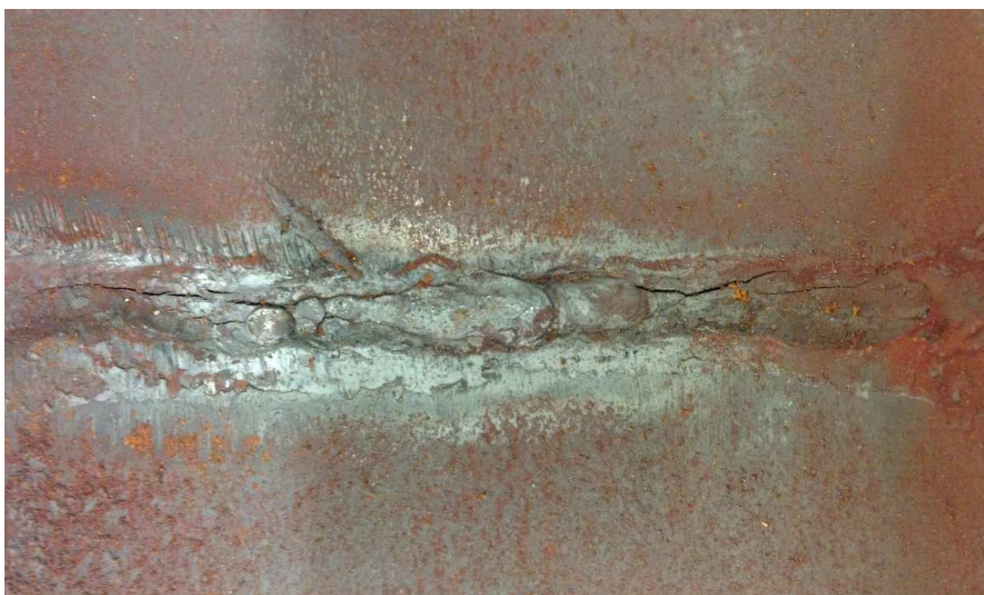
Figura 3 - Seção do Half-pipe Jackets trincado na junta de topo – parte interna.
