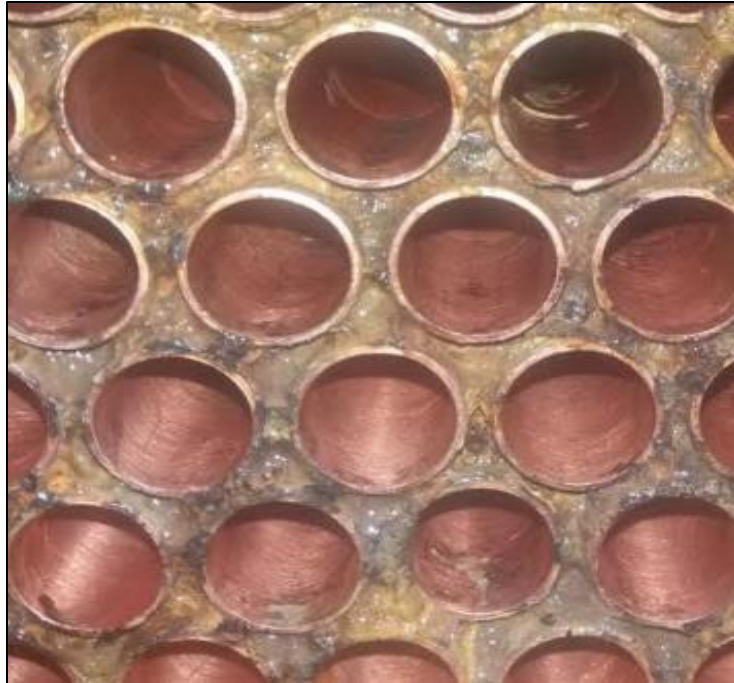
Figura 04: Tubos de cobre sem incrustação.
