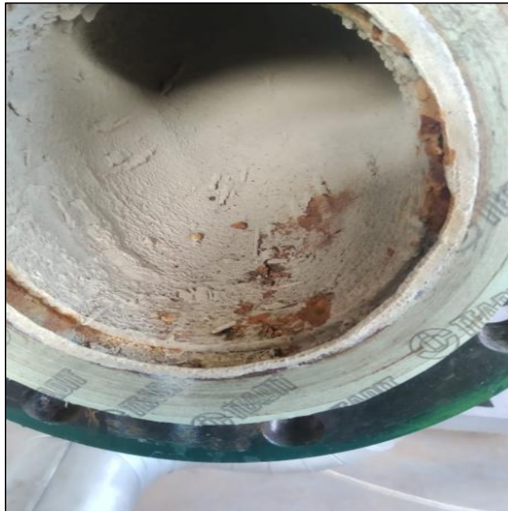
Figura 06: Material incrustado na entrada no trocador de calor.
