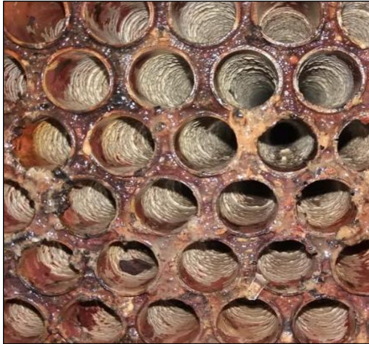
Figura 05: Tubos de cobre com incrustação.
