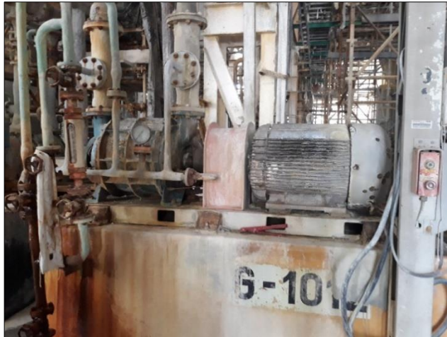
Figura 18: Conjunto Motor Bomba presente no FM I e FM II
