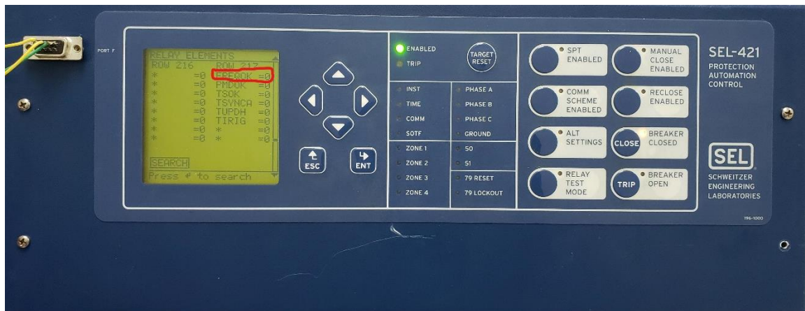
Figura 35 - Detecção Da Atuação Da Função 25 No SEL 421 Na Bancada GTD
