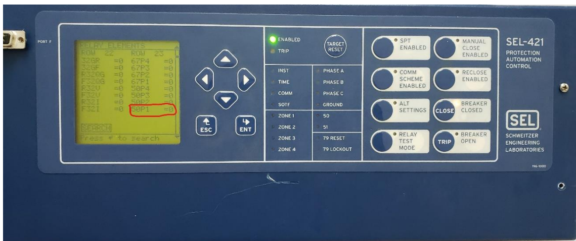
Figura 39 - Detecção Da Atuação Da Função 50 No SEL 421 Na Bancada GTD
