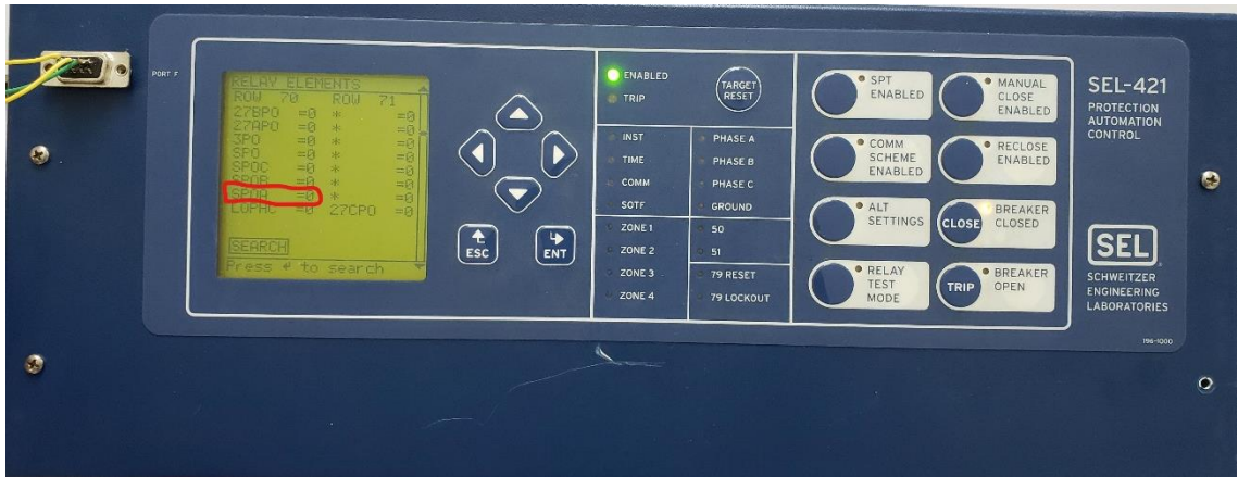
Figura 47 - Detecção da atuação da função SPOA no SEL 421 na bancada GTD
