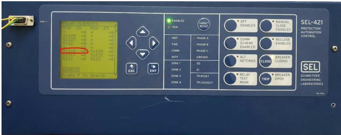
Figura 43 - Detecção Da Atuação Da Função 51 No SEL 421 Na Bancada GTD
