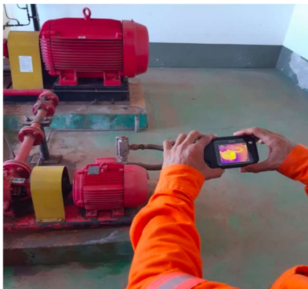
Figura 7 - Termografia de Motor Elétrico.
