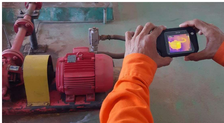
Figura 18 - Termografia do Conjunto Motor-Bomba.
