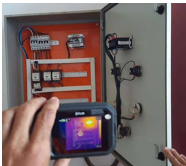
Figura 6 - Processo de Termografia em um Painel Elétrico.
