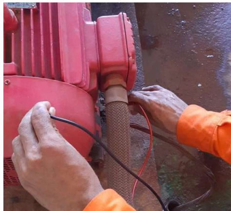
Figura 20 - Multímetro como Instrumento para Atestar o Aterramento de Motor.
