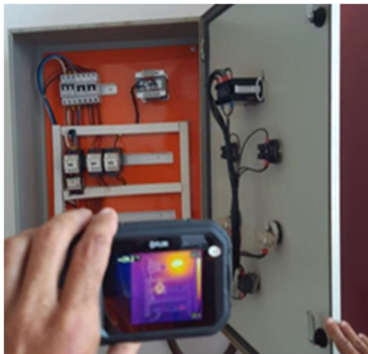
Figura 36 - Inspeção Termográfica em um Painel Elétrico.
