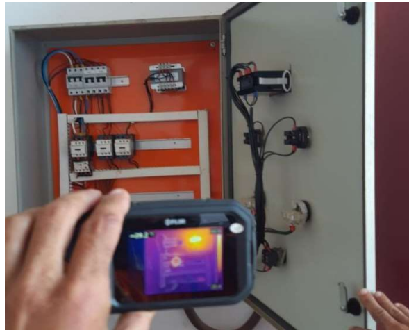
Figura 16 - Procedimento de Termografia em Painel de Motores Elétricos.
