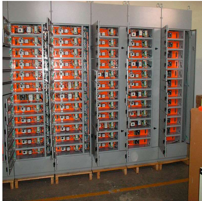
Figura 32 - Exemplo de um Centro de Controle de Motores.
