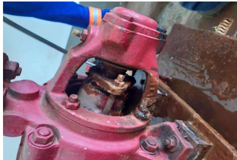
Figura 19 - Motor de Combate a Incêndio Apresentando Vazamento de Água.
