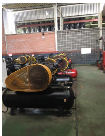
Figura 52: Sala de geração de ar comprimido – Compressores.
