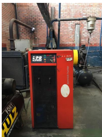
Figura 53: Secador de Ar Domnick Hunter - sala de geração de ar comprimido.
