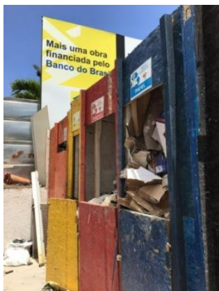
Figura 5: Resíduos acondicionados em baias
