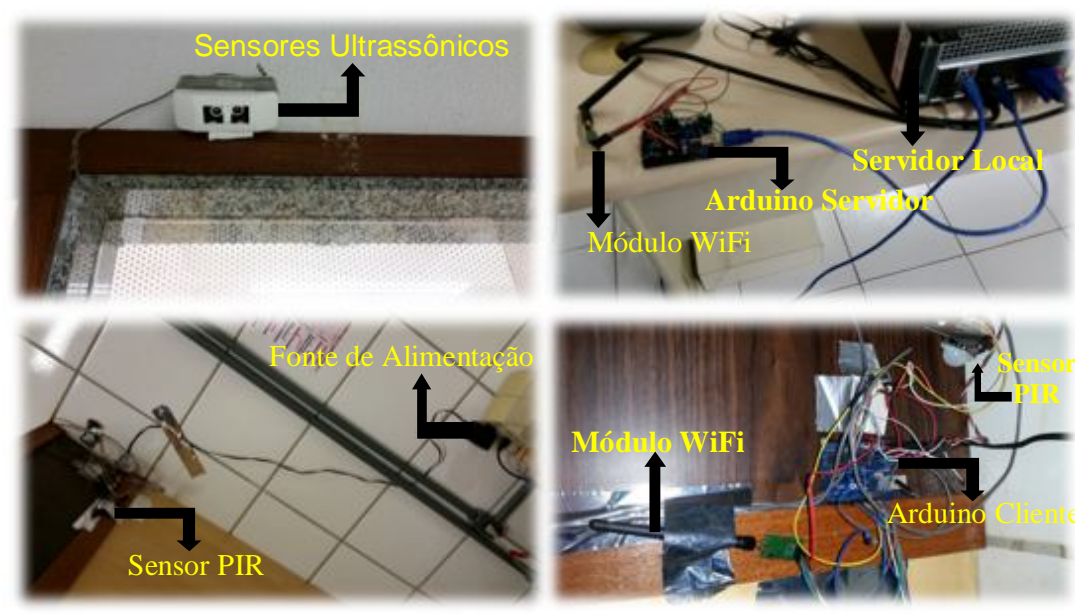
Figura 2049: Dispositivos instalados no local para o sensoriamento do ambiente. Fonte: Autor
