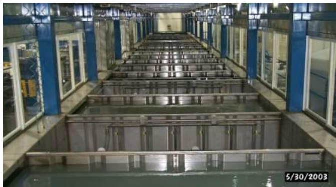
Figura 4.8: Foto ilustrativa de uma instalação de processo de pintura "Stop and Go" – Etapa de Pré Tratamento
